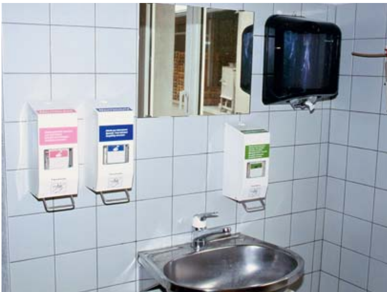
Bild 18: Waschstation mit Creme- und Seifenspendern sowie regulierbarer Wassertemperatur in einem Betrieb der Zementindustrie.
